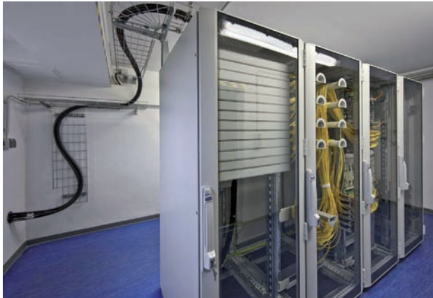
HUB Standort für das Glasfasernetz in der Stadt Premnitz
