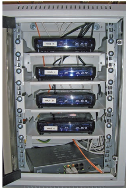
dLAN 200 DSpro Mastergeräte zur Versorgung der Gebäudesegmente
