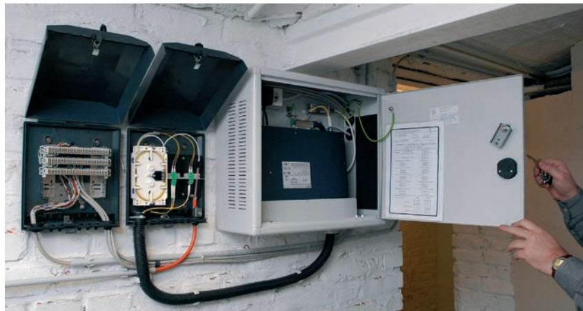
Der Micro-DSLAM, der Glasfaserabschluss und der Zwischenverteiler zur Aufschaltung der eingehenden Kundenanschlüsse (im Bild v.r.)
