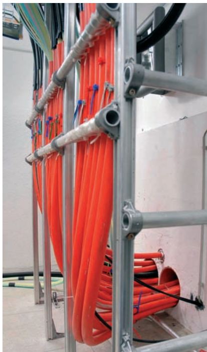
Microtubes im Technikraum
