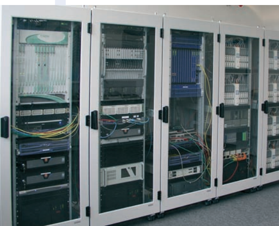
Die komplett eingerichtete Kopfstelle mit Server, CMTS, Voice Switch System SAFARI C 3 und einem WISI OV-Headend
